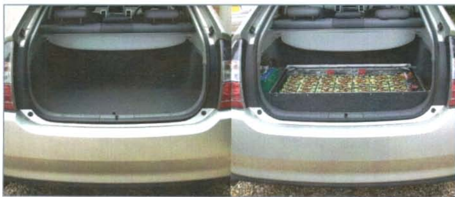
Figur 5. Bilder av batterisystemet, 'före' till vänster och 'efter' (till höger).
